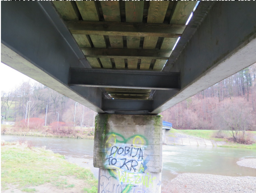
Fot. 3 Konstrukcja nośna kładki w widoku od spodu - belki stalowe z poprzecznicami, pomost drewniany.
