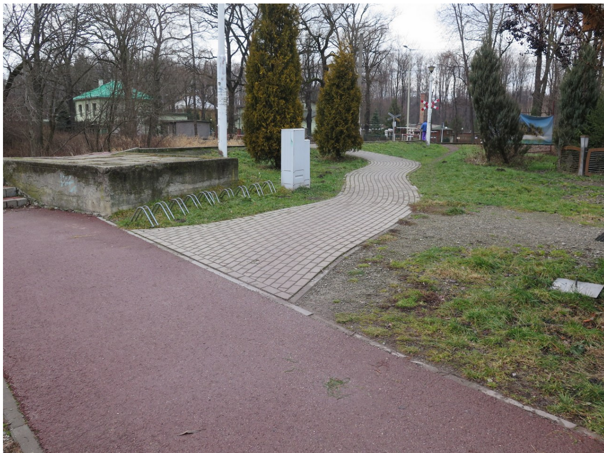
Fot. 11 Strefa wejściowa na istniejącą kładkę na prawym brzegu - widoczna betonowa rozbudowana ściana oporowa do rozbiórki.
