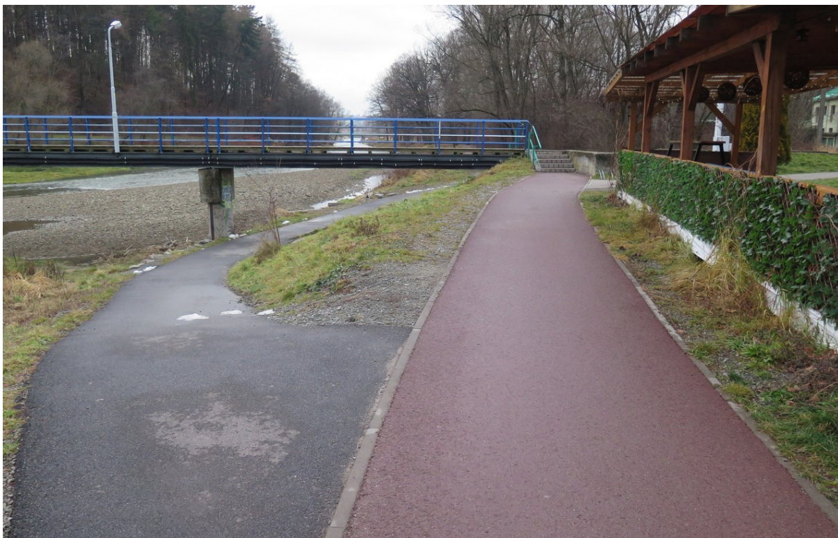
Fot. 10 Strefa wejściowa na istniejącą kładkę na prawym brzegu - widok od strony górnej wody.
