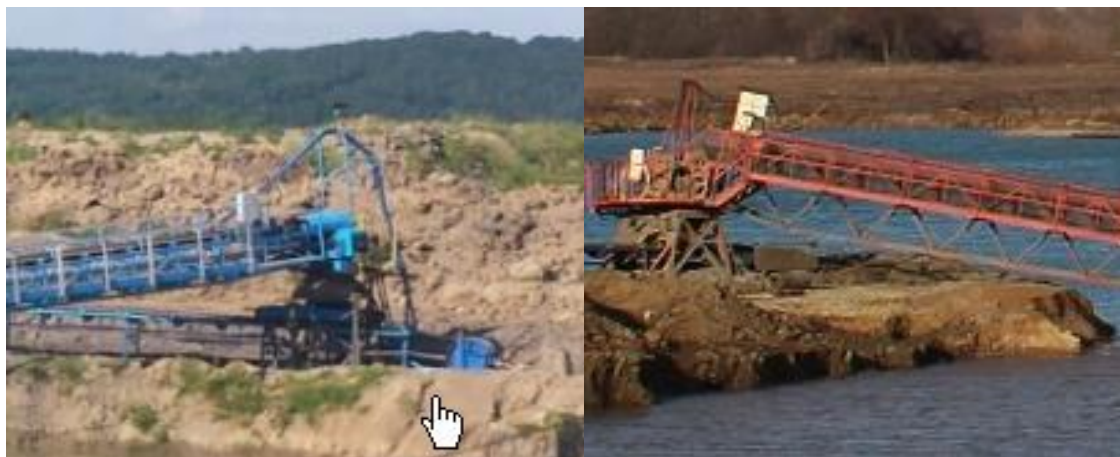
Rys. 4.2. Przykładowe lądowe stacje zasypowe.
